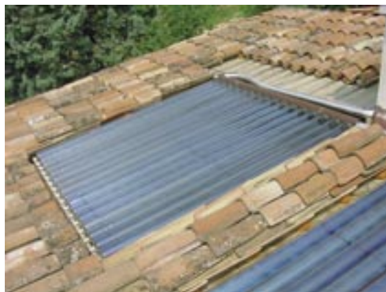
Collettore solare con il serbatoio nel sottotetto.
