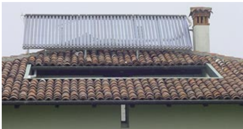
Collettori solari sottovuoto installati sul tetto
